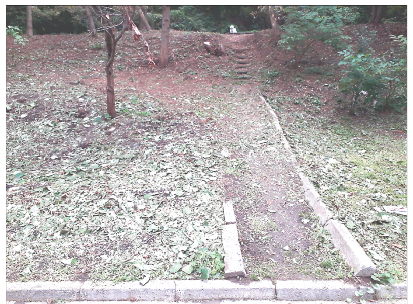
Schody (ul. Kownackiej, ul. Petöfiego) przed naprawą.
