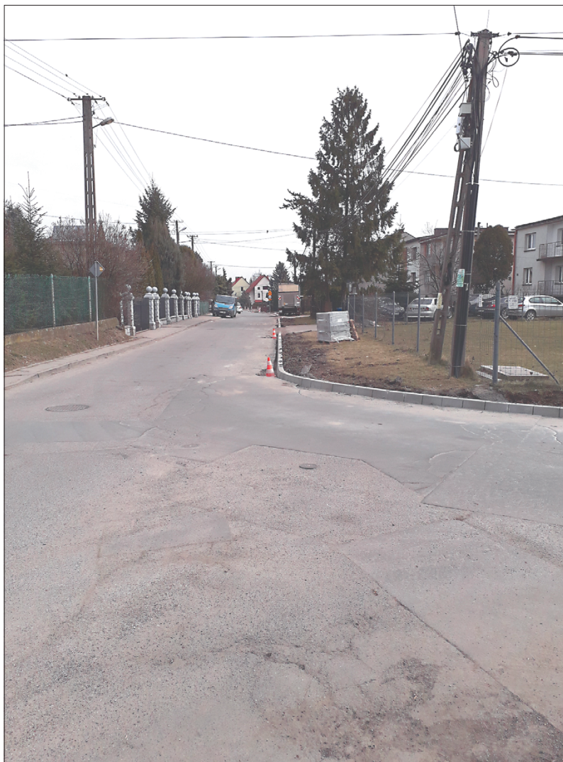
Ulica Grębałowska przed naprawą.
