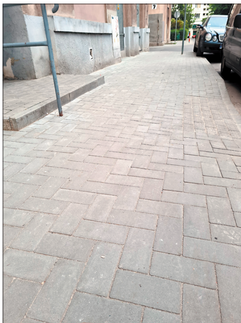
Os. Centrum B – nieprawidłowy spadek na chodniku.
