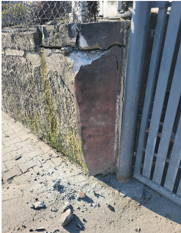
Ulica Mistrzejowicka - zniszczone ogrodzenia
